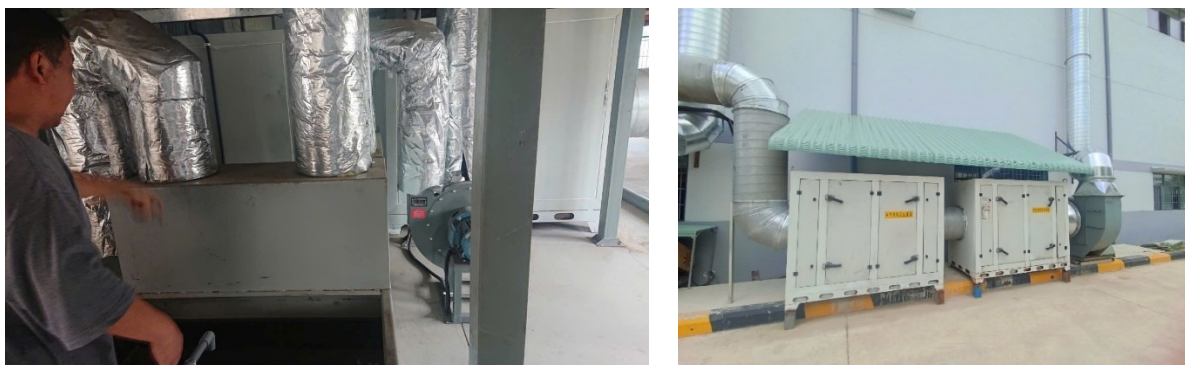
Hình 4.11 Hệ thống xử lý khí thải phát sinh từ lò đốt số 2
