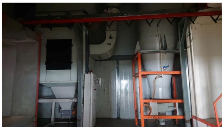
Cyclone và thiết bị filter lọc bụi trung tâm
